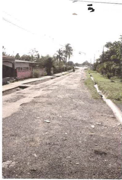
Figuras III: Fotografías del estado actual de la vía
